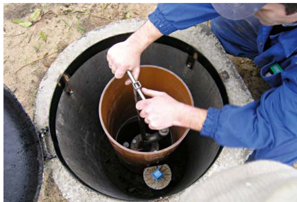
Fot.2. Bezpieczny demontaż zaworu z poziomu terenu. (zamienia się zawór na sprawny lub montuje się zaślepkę)
