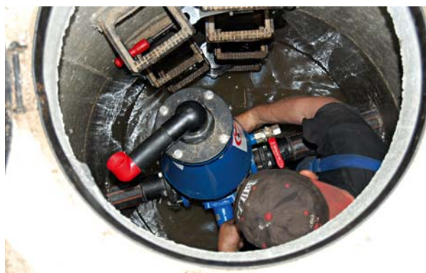
Fot.1. Demontaż zaworu odpowietrzająco-napowietrzającego w studni włazowej \Phi 1200 mm (warunki zagrożenia utratą życia i zdrowia – praktyka jest taka, że demontuje się zawór po uprzednim wejściu do studzienki włazowej i przewozi się go na warsztat)
