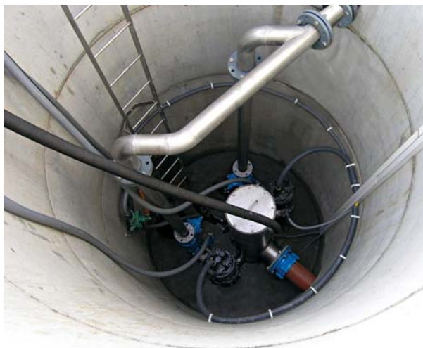
Fot. 4. Przepompownia z komorą suchą i z pompami ustawionymi na sucho po kilku latach eksploatacji
