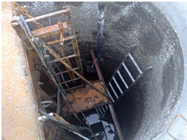
Fot. 3. Klasyczna przepompownia z mokrą komorą i z pompami zatapialnymi po kilku latach eksploatacji
