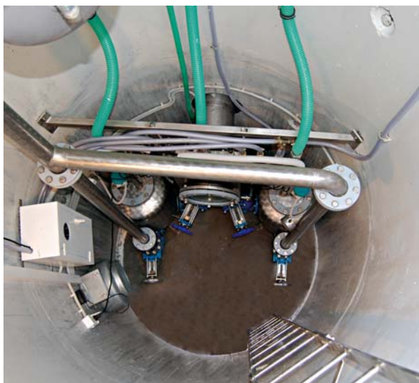
Fot. 5. Pneumatyczna tłocznia ścieków z roboczymi zbiornikami wyporowymi w komorze suchej
